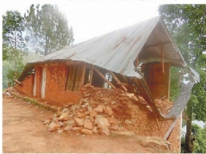
日本からの支援で2001年完成した待望の校舎。地震で全壊状態に
